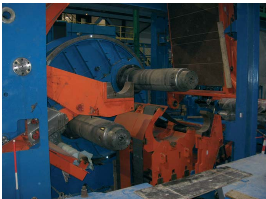
Gewaltige Maschinen und Werkzeuge präzise einrichten – die besondere Herausforderung an unsere Ingenieure.
